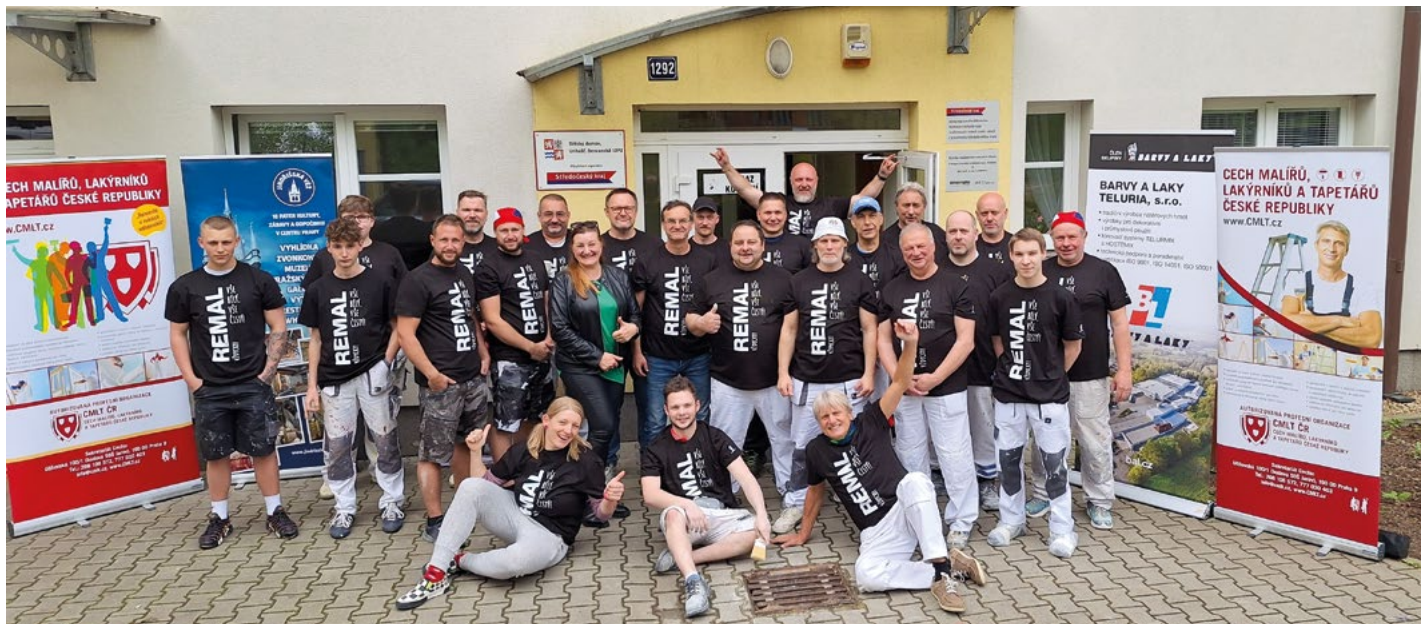
Osm chodeb a schodiště vymalovali zdarma členové Cechu malířů, lakýrníků a tapetářů ČR v Dětském domově Unhošť
